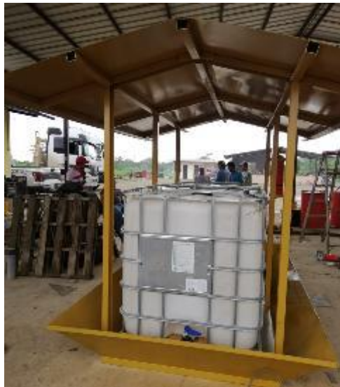
Ilustración 20. Cubeto para almacenamiento de combustible.
