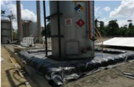
Figura 35 Almacenamiento de Combustibles TIPO
