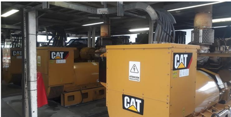
Figura 28 Área Generadores TIPO
