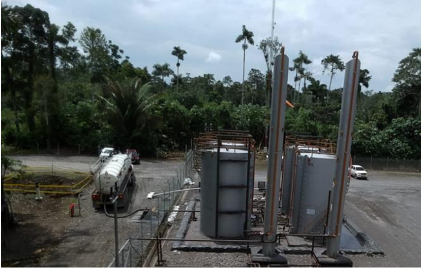
Figura 33 Tanque de Almacenamiento de Crudo TIPO
