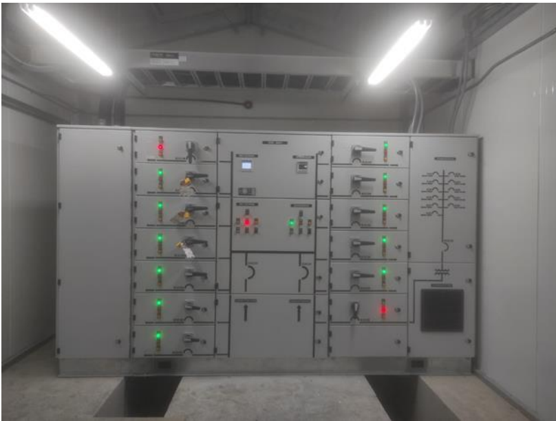
Figura 37 Área de Equipos de Potencia eléctrica (Shelters) TIPO
