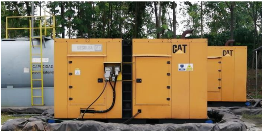
Figura 38 Área Generadores TIPO
