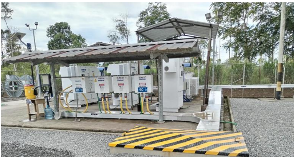
Figura 36 Área de Transformadores y Variadores TIPO
