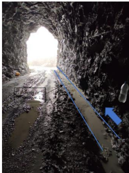
Figura 181. Drenaje de aguas provenientes de las tolvas almacén. Fuente: Departamento técnico “Quebrada Fría”
