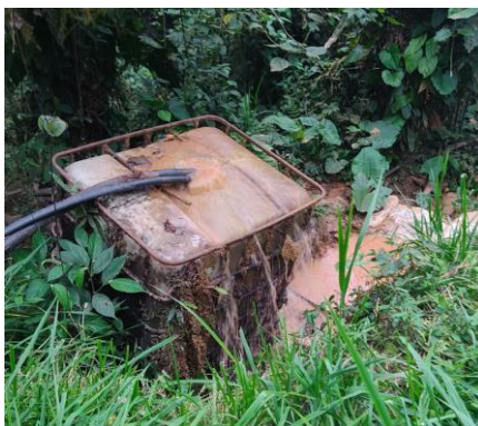
Figura 190. Tanque sedimentador 1. Fuente: Departamento técnico “Quebrada Fría”.
