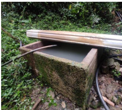
Figura 188. Tanque sedimentador 2. Fuente: Departamento técnico “Quebrada Fría”.
