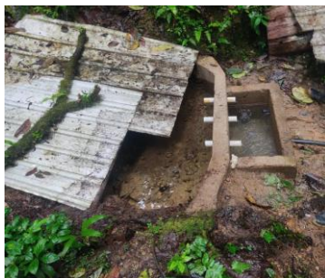
Figura 187. Punto de captación 2, vertiente de agua natural canalizada. Fuente: Departamento técnico “Quebrada Fría”
