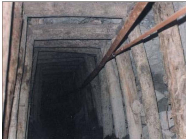
Figura 160. Avances en mineral-Fortificación con madera (zonas inestables) de la Sociedad “24 de Mayo” Fuente: Administrador de la concesión Quebrada Fría. Elaboración: Equipo consultor, 2023.
