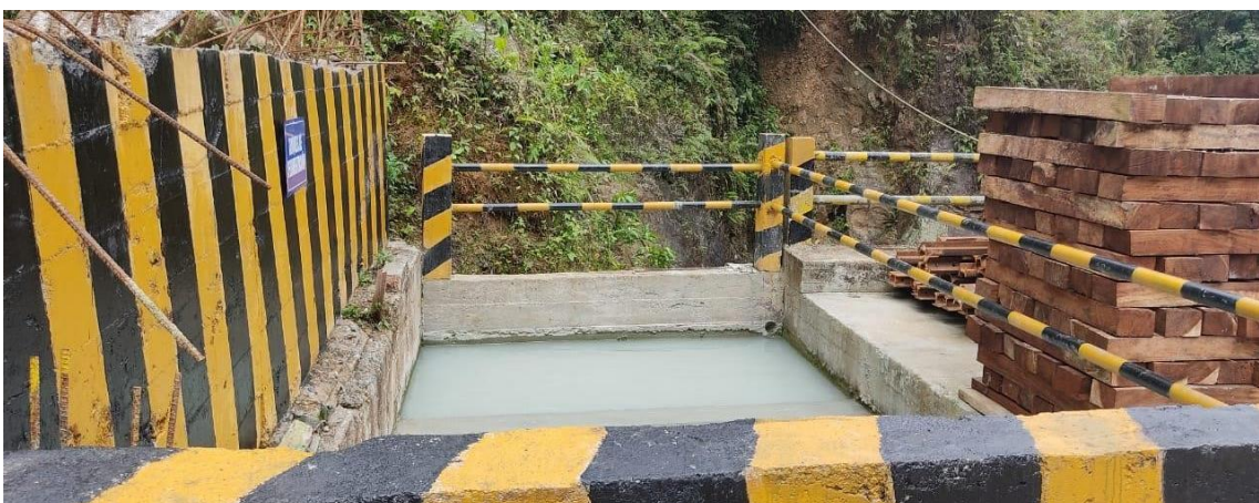
Figura 165. Sedimentador de aguas provenientes de la escombrera como de interior mina. Fuente: Departamento técnico “Quebrada Fría”
