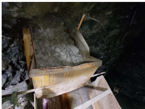
Figura 180. Buzón de tolva para caja lleno. Fuente: Departamento técnico “Quebrada Fría”
