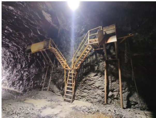
Figura 177. Buzones para el vertido de material de caja y veta (actual escombrera) Fuente: Departamento técnico “Quebrada Fría”
