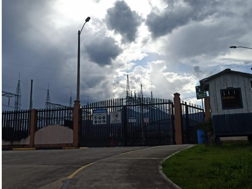
Fotografía 1 S/E Bomboiza a 230 kV
