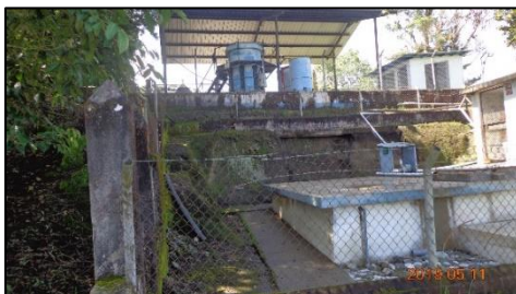
Foto 029 Tanques de agua Fecha: 10/05/2019 Fuente: Gesambconsult
