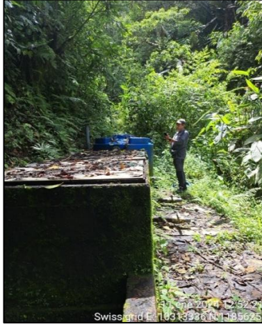
Foto 051 Tanque de captación de agua para consumo humano Fecha: 11/01/2024 Fuente: Gesambconsult
