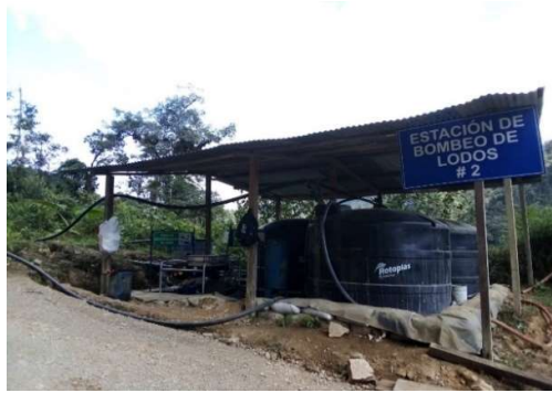
Figura 8-38 Tanques de transferencia de fluido descartado Fuente: GREEN ROCK RESOURCES GRR SA., junio 2023
