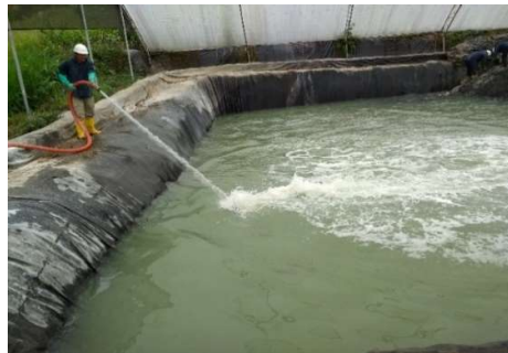
Figura 8-42 Recirculación por Medio de Bomba
