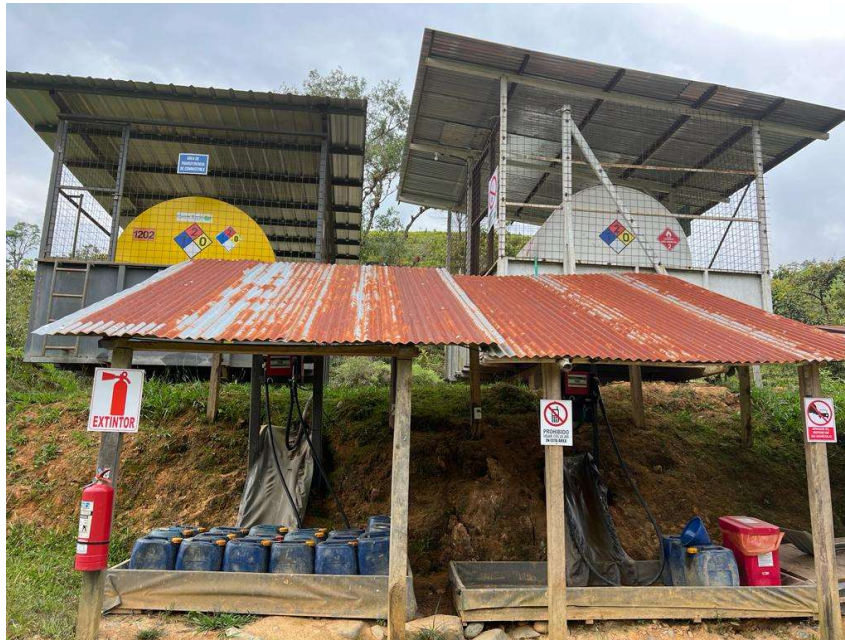
Figura 8-28 Área de Almacenamiento de Combustible
