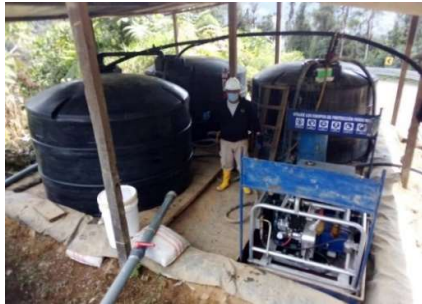
Figura 8-39 Red de bombeo de fluidos descartados Fuente: GREEN ROCK RESOURCES GRR SA., junio 2023
