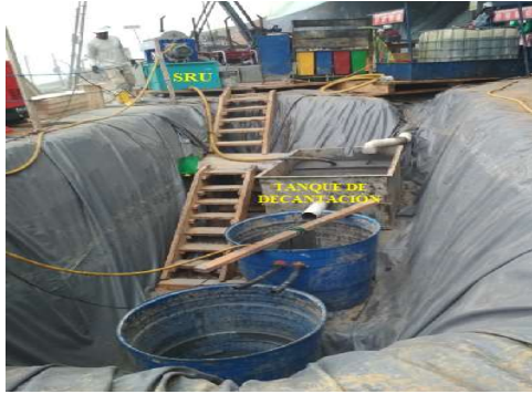
Figura 8-37 Fosas de recirculación Fuente: GREEN ROCK RESOURCES GRR SA., junio 2023
