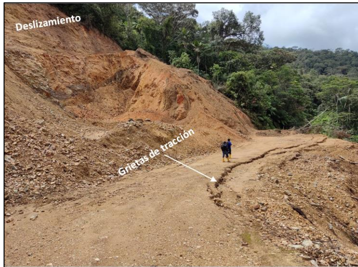
Fotografía 9-1 Deslizamiento Combinado Rotacional Ubicado en la Vía de Acceso al Proyecto Panantza. Localizado en las coordenadas 783.300,97E y 9.650.380,86N, 887 msnm, grietas profundidad >70cm, abertura 13cm - 20cm LT= 48m
