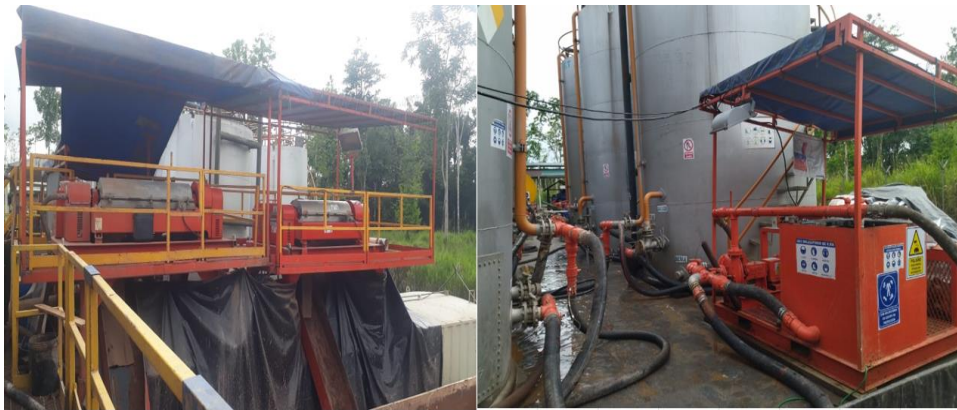
Figura 26 Sistema de Deshidratación de lodos TIPO
