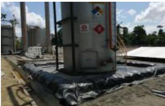
Figura 30 Almacenamiento de Combustibles TIPO
