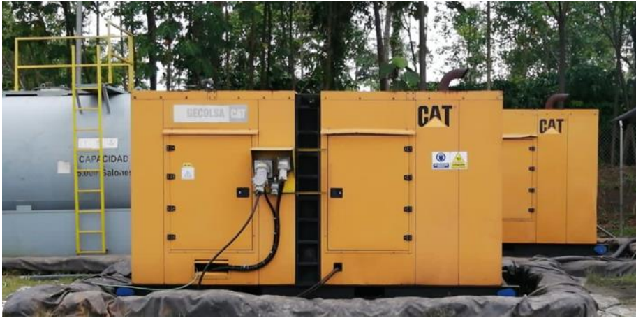
Figura 40 Área Generadores TIPO
