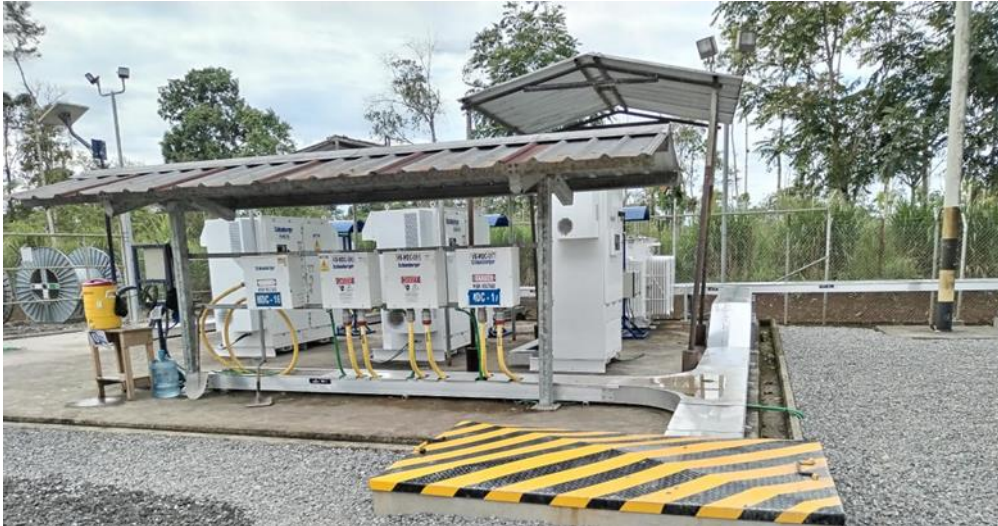
Figura 38 Área de Transformadores y Variadores TIPO
