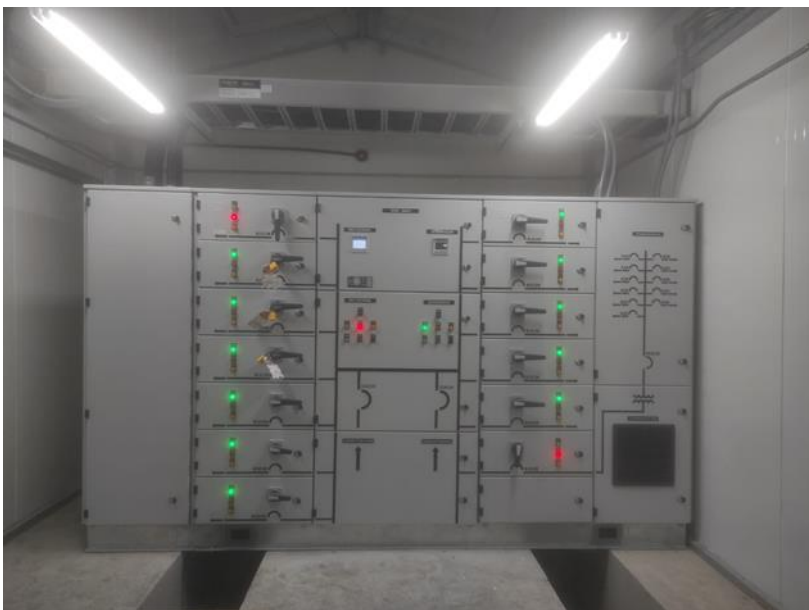
Figura 39 Área de Equipos de Potencia eléctrica (Shelters) TIPO
