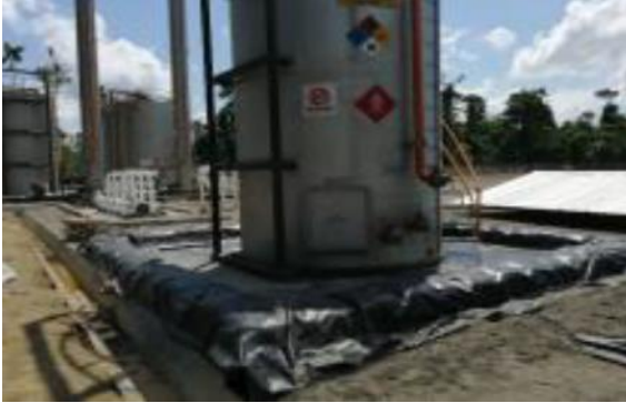
Figura 37 Almacenamiento de Combustibles TIPO
