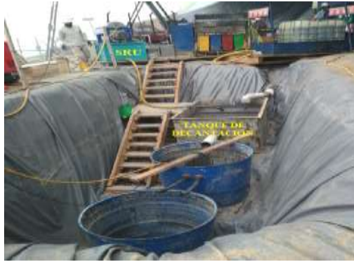
Figura 8-37 Fosas de recirculación
