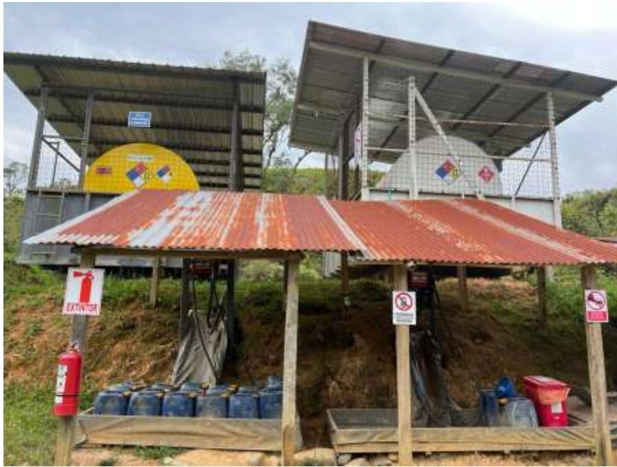
Figura 8-28 Área de Almacenamiento de Combustible
