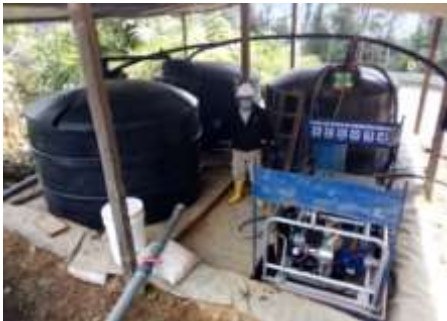
Figura 8-39 Red de bombeo de fluidos descartados Fuente: GREEN ROCK RESOURCES GRR SA., junio 2023
