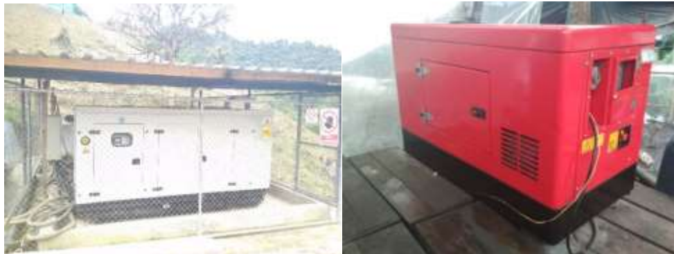
Figura 8-29 Generadores Eléctricos Tipo Utilizados
