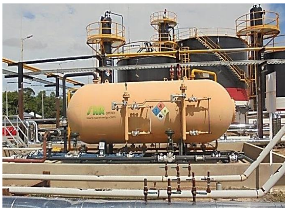
Figura 5-10 Separador de gas
