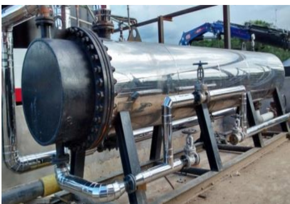
Figura 5-12 Intercambiador de calor
