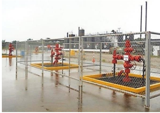
Figura 5-7 Cabezales de pozo ubicados en una misma plataforma
