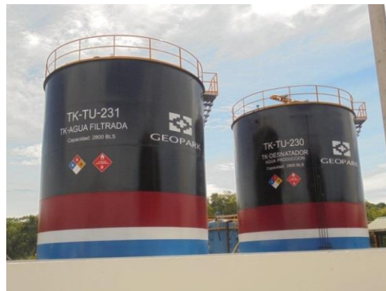
Figura 5-19 Skimming Tank y Tanque de agua filtrada
