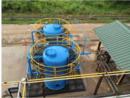
Figura 5-18 Sistema de tratamiento de agua de producción para disposición en pozos – filtros de lecho filtrante
