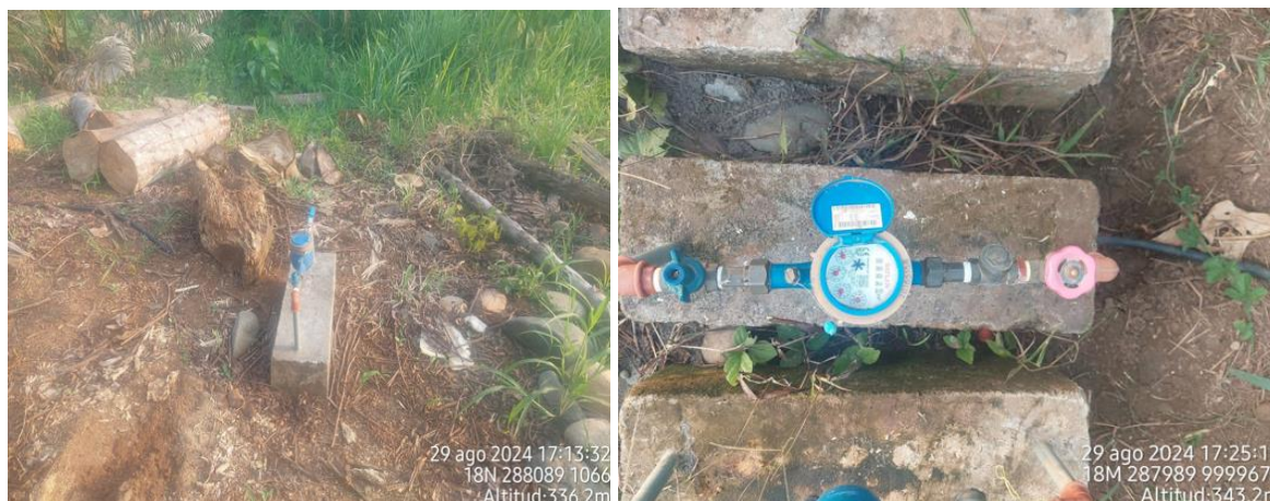
FIGURA N° 4.6.29.- MEDIDORES DE AGUA SR. HUATATOCA Y EL SR. YUMBO
