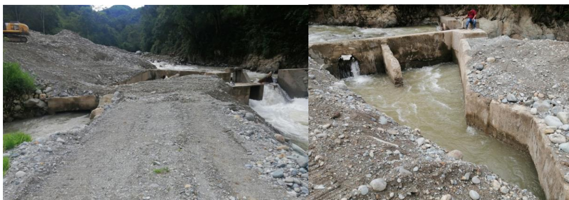
Imagen 7.7. Punto de captación
