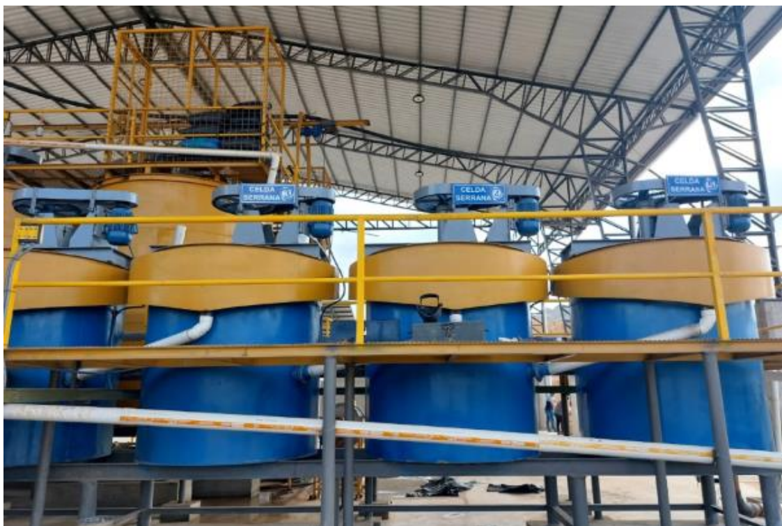
Imagen 7.13. Celdas de flotación
