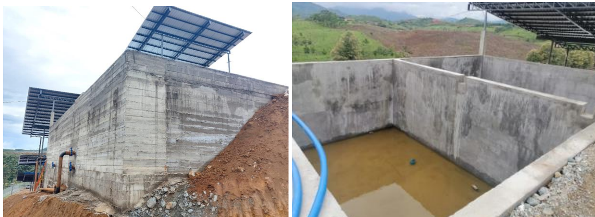
Imagen 7.9. Tanque de almacenamiento de agua
