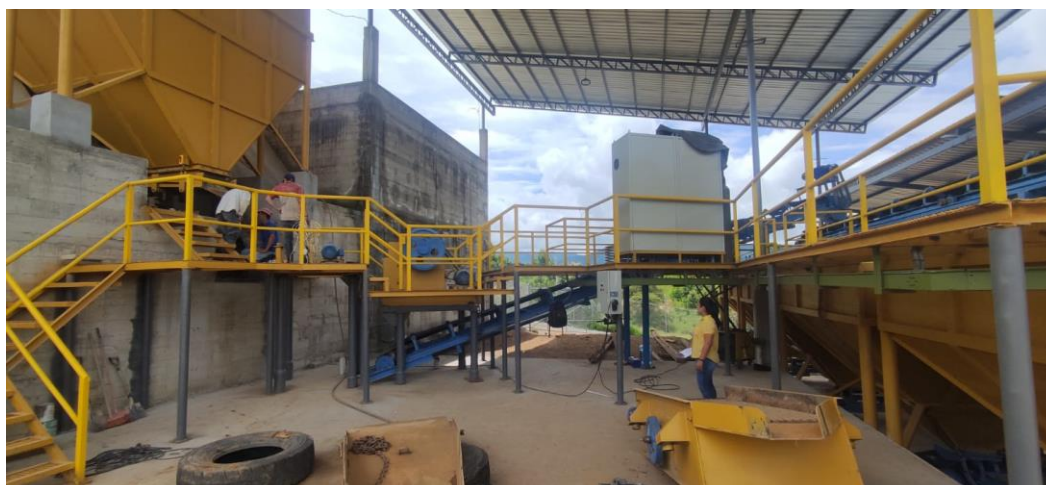
Imagen 7.10. Instalación de Zaranda y trituradora de mandíbulas
