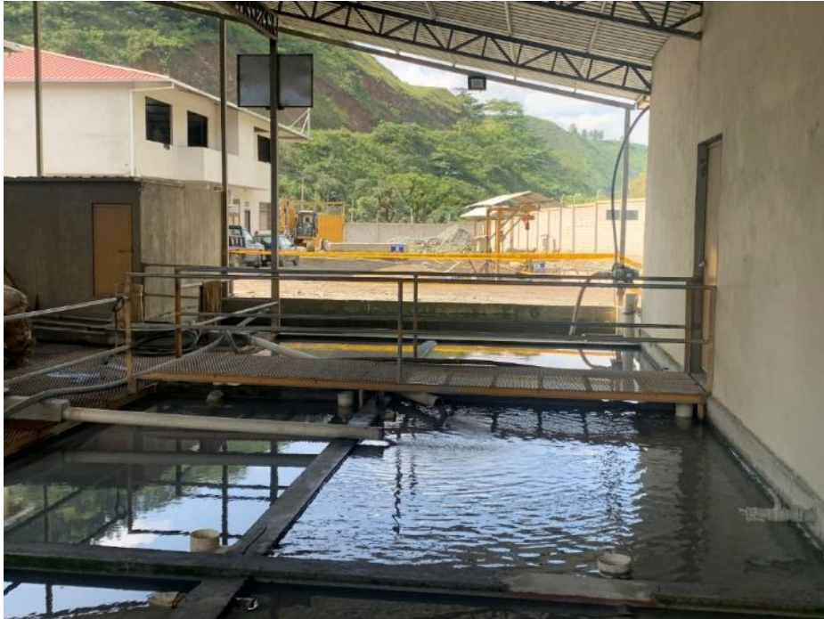
Figura 4-30 Piscina de sedimentación, arenas de molienda.
