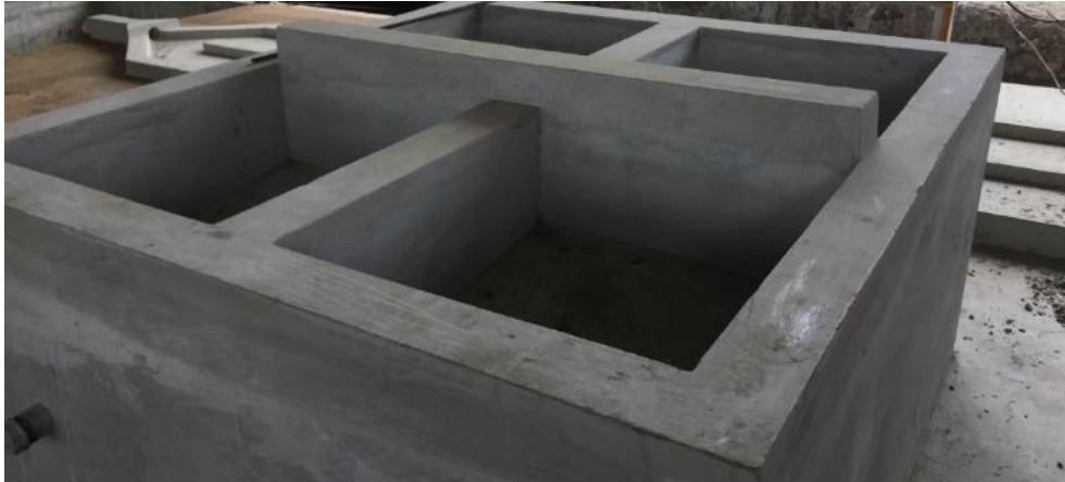
Figura 4-5 Estanque de cemento
