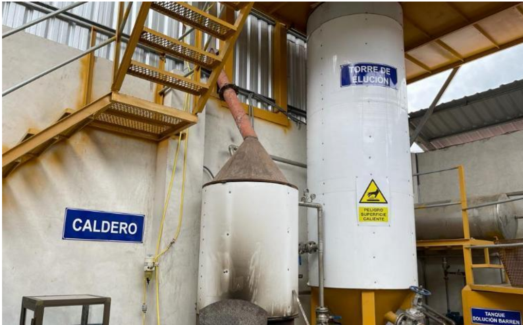
Figura 4-10 Torre de elución
