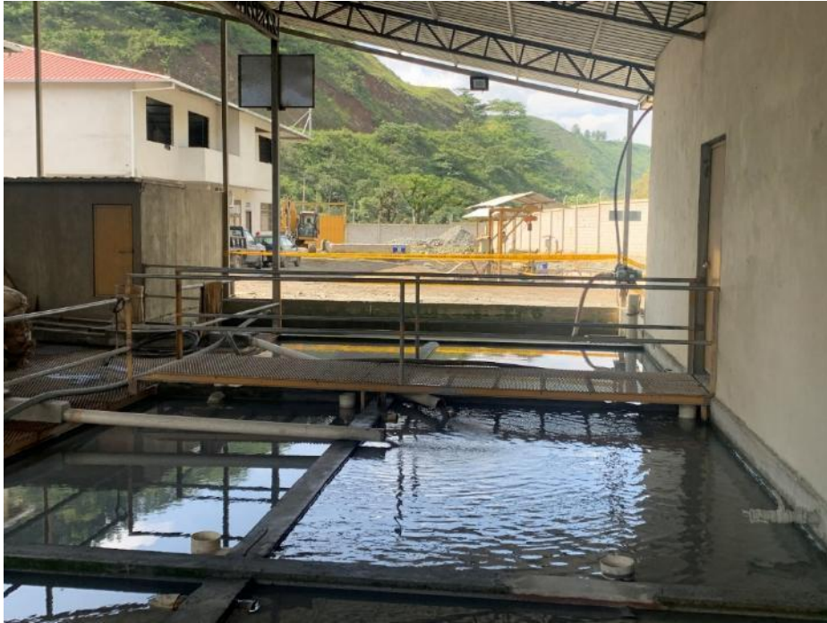
Figura 4-9 Piscina de sedimentación, arenas de molienda.
