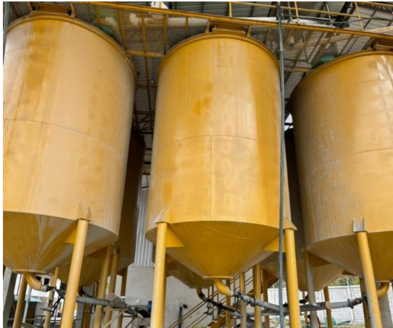
Figura 4-26 Tanques agitadores para la cianuración con carbón activado
