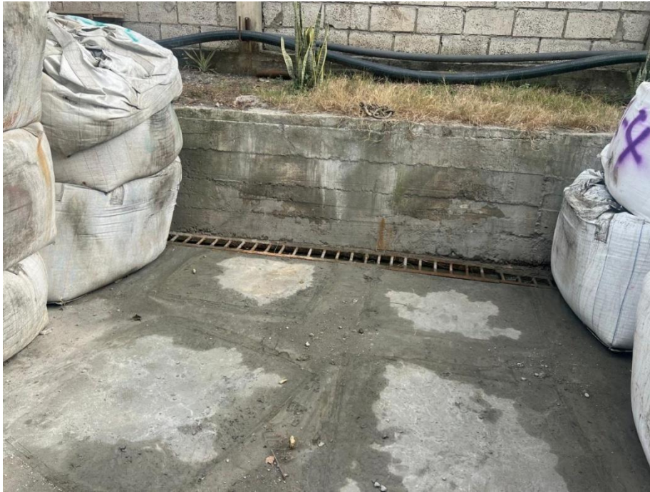
Figura 4-16 Detalle de la canaleta que conduce los lixiviados hacia el cubeto de recolección.
