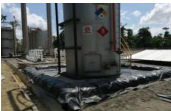
Figura 31 Almacenamiento de Combustibles TIPO
