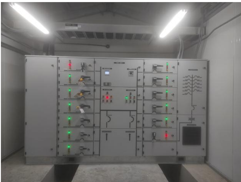
Figura 40 Área de Equipos de Potencia eléctrica (Shelters) TIPO
