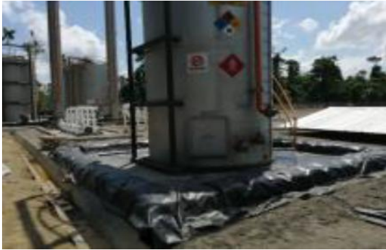
Figura 38 Almacenamiento de Combustibles TIPO
