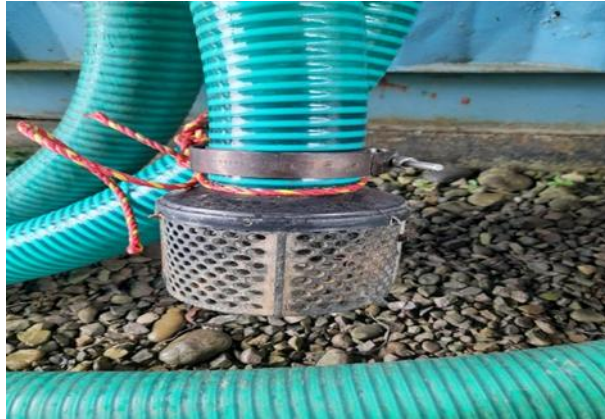
Figura 43 Tubería y/o manguera para Captación de Agua TIPO
