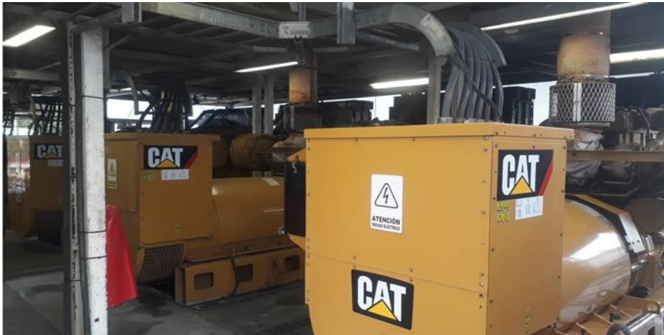
Figura 29 Área Generadores TIPO
