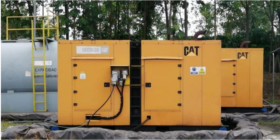
Figura 41 Área Generadores TIPO
