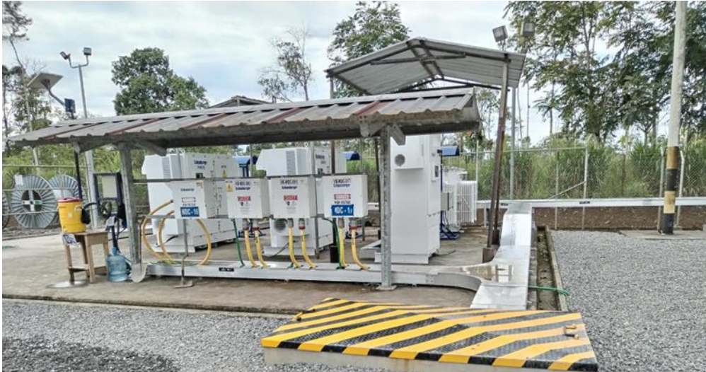
Figura 39 Área de Transformadores y Variadores TIPO
