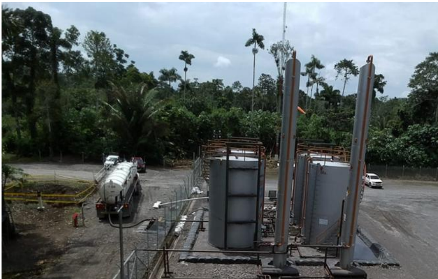
Figura 36 Tanque de Almacenamiento de Crudo TIPO
