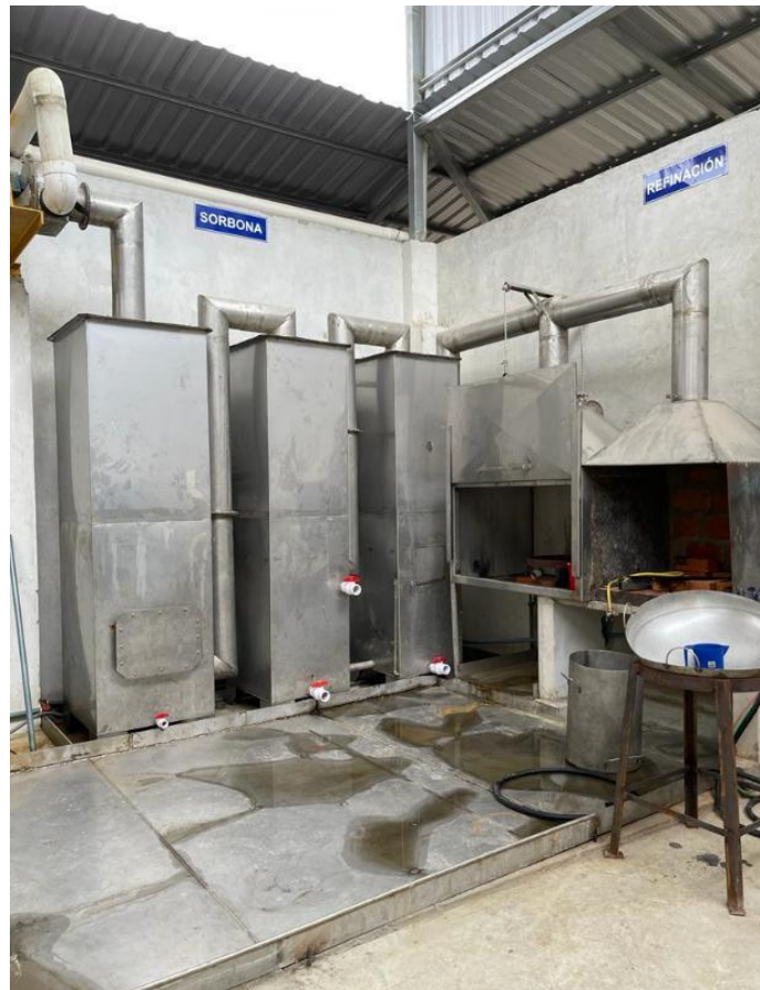
Figura 22 Área de fundición Elaborado por: ENERMILL CIA. LTDA./TAIAO CONSULTORES, 2026
