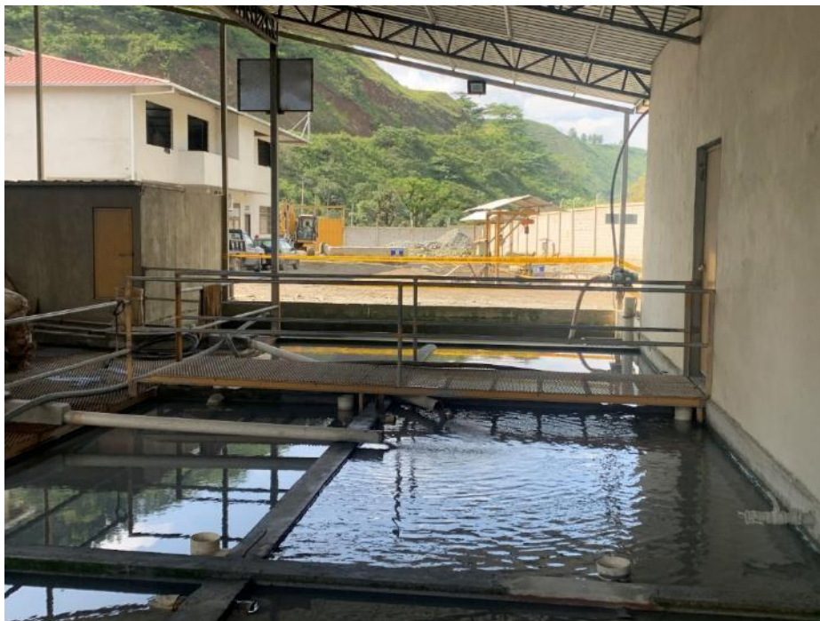
Figura 18 Piscina de sedimentación, arenas de molienda.
