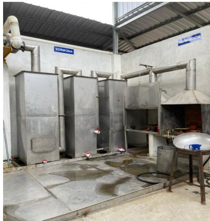
Figura 40 Área de fundición y refinación.
