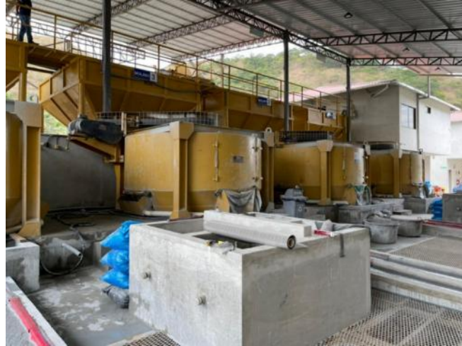
Figura 36 Área de molienda Elaborado por: ENERMILL CIA. LTDA./TAIAO CONSULTORES, 2026
