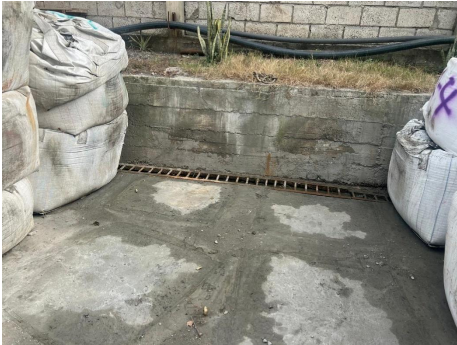
Figura 29 Detalle de la canaleta que conduce los lixiviados hacia el cubeto de recolección. Elaborado por: ENERMILL CIA. LTDA./TAIAO CONSULTORES, 2026
