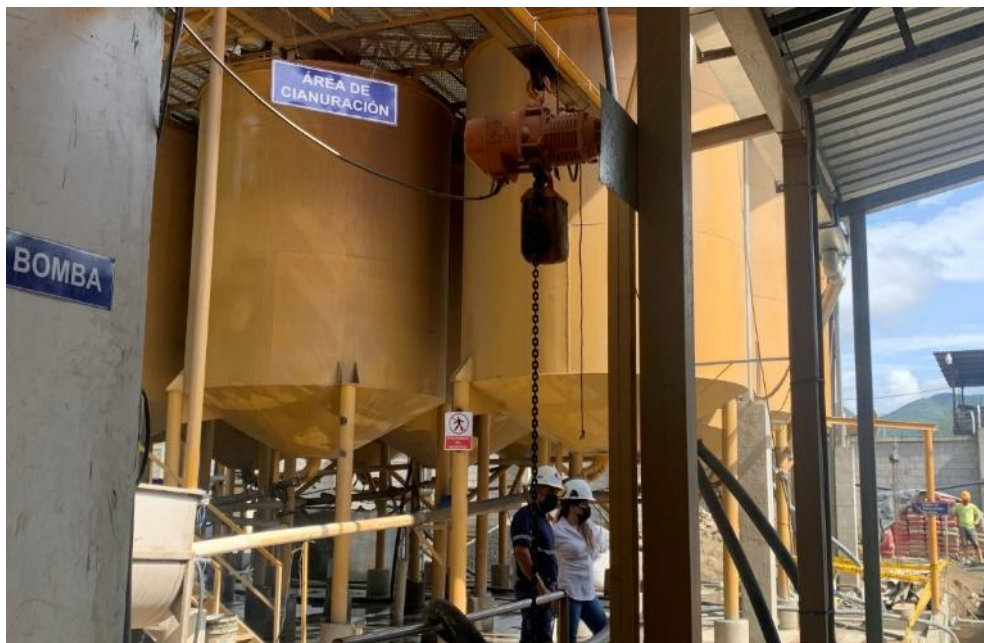
Figura 21 Tanques de cianuración y agitación Elaborado por: ENERMILL CIA. LTDA./TAIAO CONSULTORES, 2026
