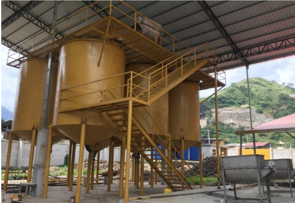
Figura 20 Tanques de cianuración y agitación Elaborado por: ENERMILL CIA. LTDA./TAIAO CONSULTORES, 2026
