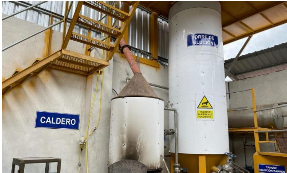
Figura 5-14 Torre de elución
