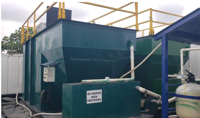
Foto 8. Planta de Tratamiento de las aguas residuales para perforación (red fox)
