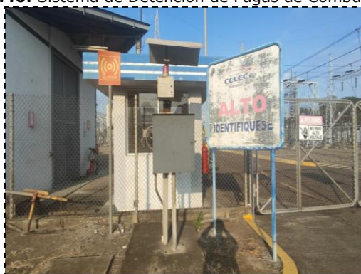
Foto 1.46: Sistema de Detención de Fugas de Combustibles 2
