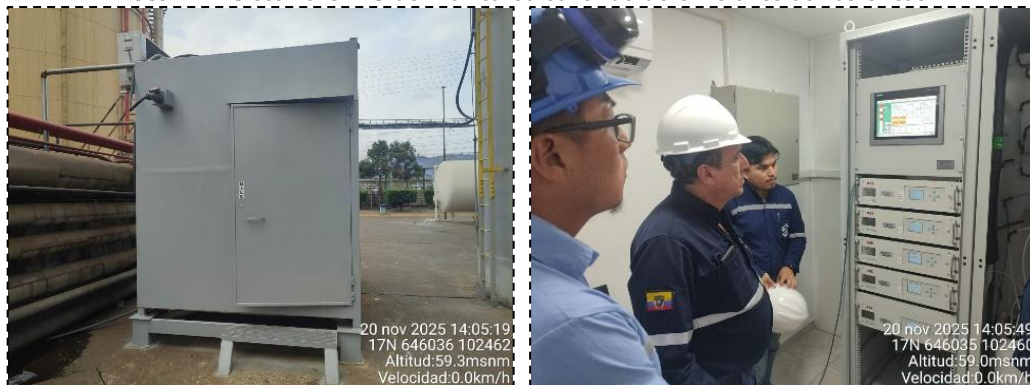
Foto 1.7: Sistema CEMS de monitoreo continuo de emisiones atmosféricas
