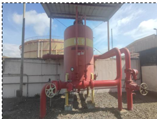
Foto 1.44: Sistema contra incendio
