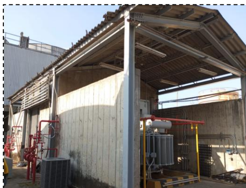
Foto 1.26: Transformadores de torre de control de enfriamiento general
