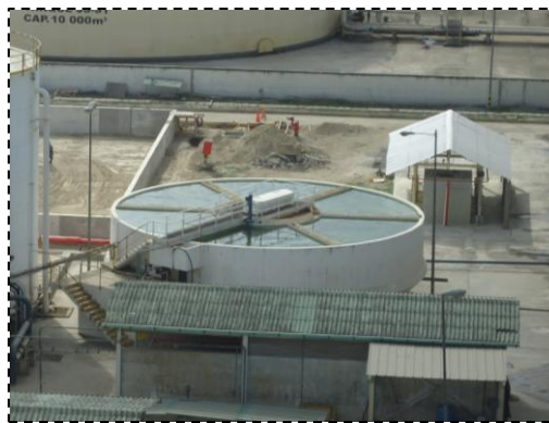
Foto 1.15: Sistema de Clarificación
