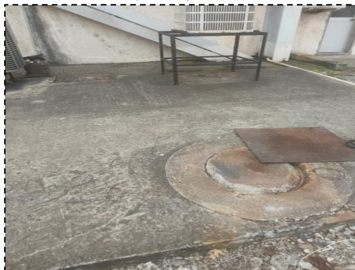
Foto 1.61: Pozo séptico operativo área de calderas
