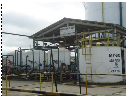
Foto 1.17: Planta de Agua Filtrada
