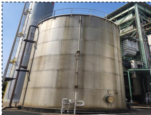
Foto 1.27: Tanque de Agua Desmineralizada
