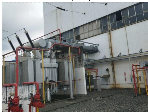
Foto 1.67: Transformador principal de marca ITALTRAFRO
