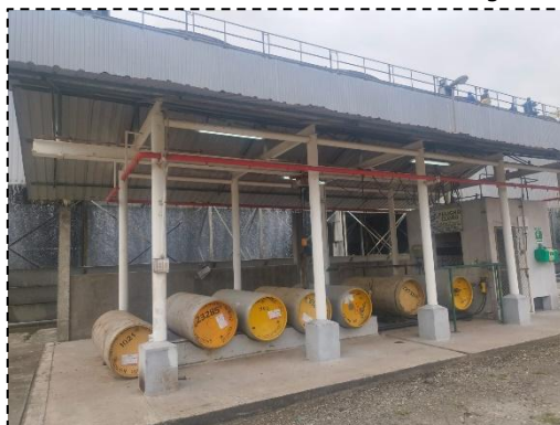
Foto 1.19: Planta de cloración del agua
