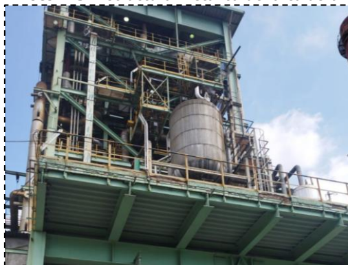
Foto 1.3: Estructura metálica de la caldera
