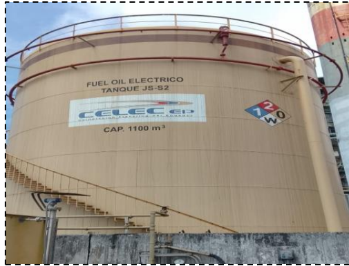
Foto 1.21: Tanque de almacenamiento de Fuel Oil - JS-S2
