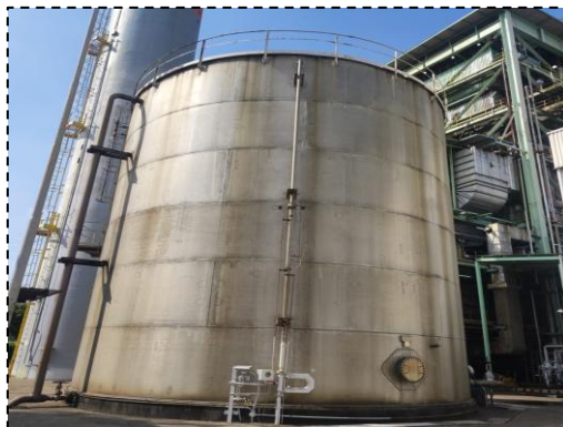
Foto 1.18: Tanque de almacenamiento del agua desmineralizada
