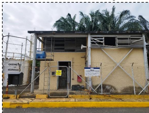
Foto 1.10: Planta de Hidrógeno
