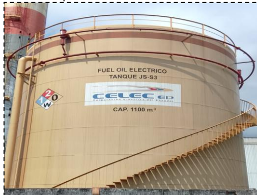
Foto 1.22: Tanque de almacenamiento de Fuel Oil - JS-S3
