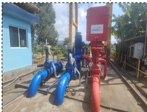
Foto 1.14: Sistema contra incendio (electrobomba)
