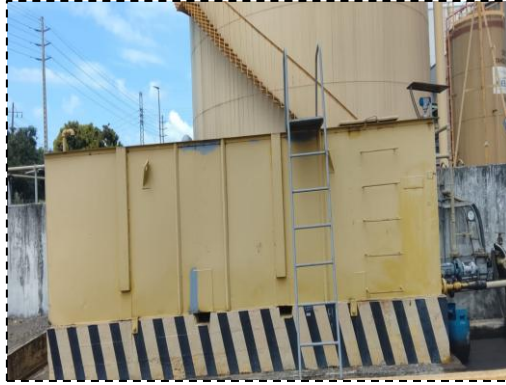
Foto 1.24: Tanque de almacenamiento de diésel JS-S6
