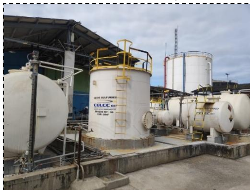
Foto 1.25: Tanques de Almacenamiento de Químicos (ácido sulfúrico e hidrógeno de sodio)
