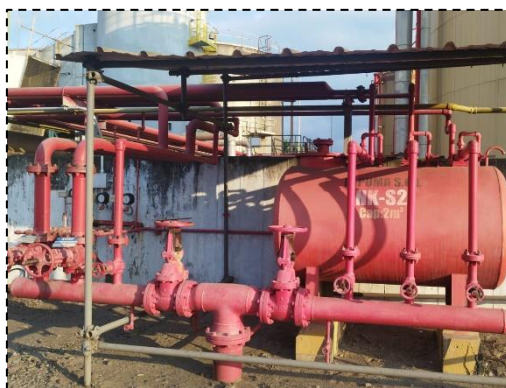
Foto 1.43: Sistema contra incendio de la CTE I
