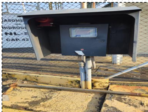
Foto 1.45: Sistema de Detención de Fugas de Combustibles 1
