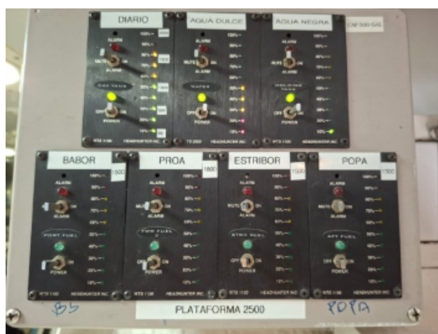
Figura N° 27. Panel de control de tanques
