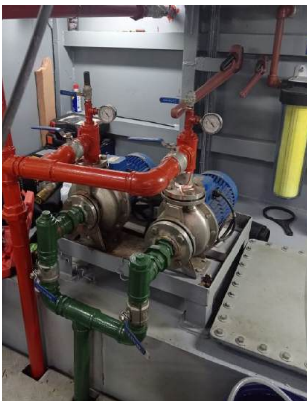
ILUSTRACIÓN 27: BOMBA DE ACHIQUE DE AGUAS DE SENTINA
