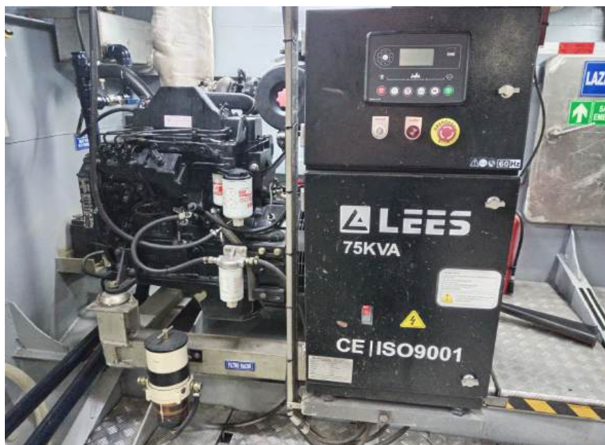
ILUSTRACIÓN 14: GENERADOR PRINCIPAL CUMMINS
