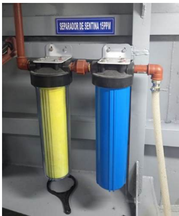
ILUSTRACIÓN 26: FILTROS SEPARADORES DE AGUAS DE SENTINAS
