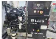
GENERADOR PRINCIPAL CUMMINS
